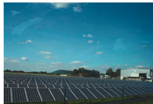
z. B. Varrel: Photovoltaikfeld
